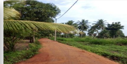
නැ.නු.ප ප්‍රා.ලේ.කො. නෙළුම් කන්තිය පිටර් රත්නායක මහතාගේ නිවස අසල සිට කුඹුරු යාය දක්වා වූ කෘෂි මාර්ගය මි.250 සංවර්ධනය කිරීම
